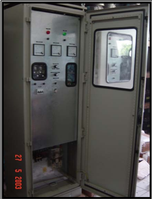
DRY TYPE UNIT TRANSFORMER RECTIFIER
